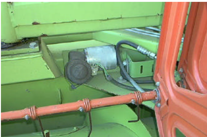
Morsetti non isolati
