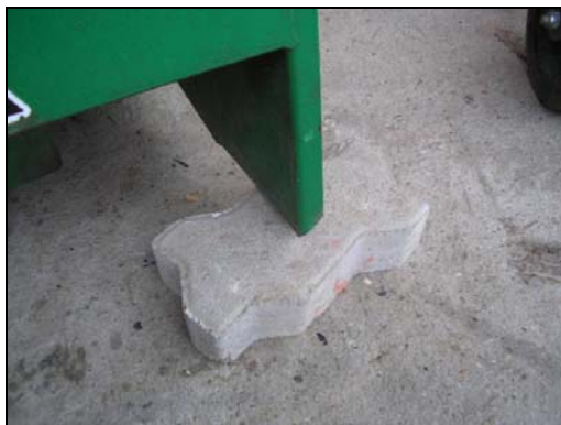
Sistema rudimentale di supporto
